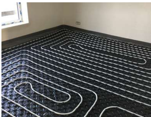
» Chauffage par le sol partout
