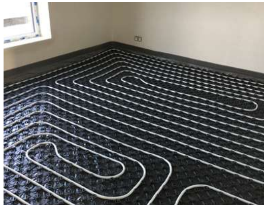
» Chauffage par le sol partout
